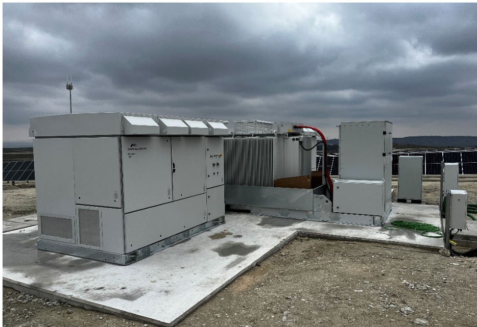
Figura 40 Centro de transformación
