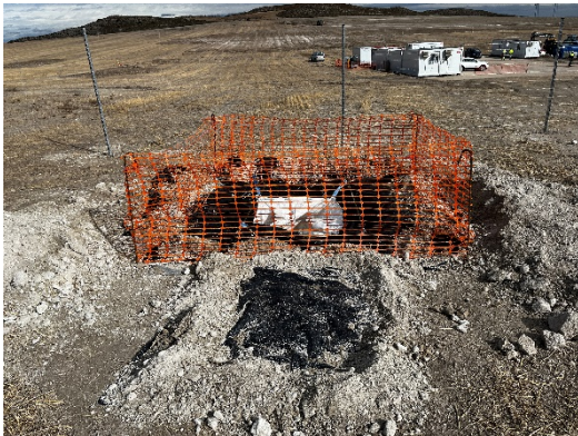
Figura 25 Lavadero de cubas de hormigón
