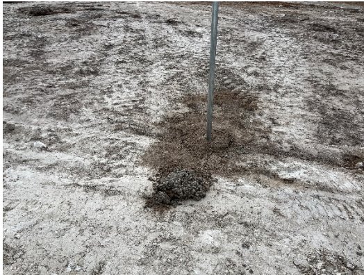
Figura 23 Pequeños vertidos de hormigón
