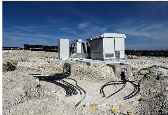
Figura 12 Cableado de los centros de transformación
